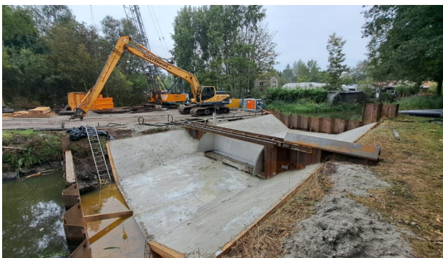
De stuwklep is geplaatst. Inmiddels zijn de tijdelijke damwanden verwijderd en staat de stuw vol met water. Pas als deze helemaal klaar is, nemen we de nieuwe stuw in gebruik. Tot die tijd blijft de oude stuw operationeel.
